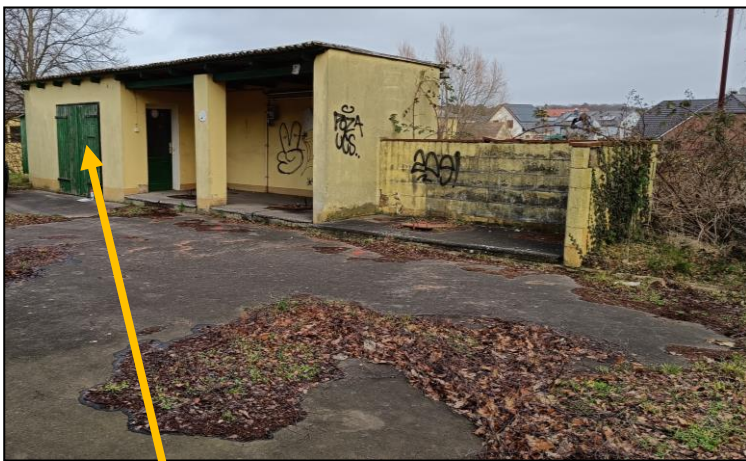
Foto 1: Öllager mit Befüllstation, Blickrichtung Nordwest
